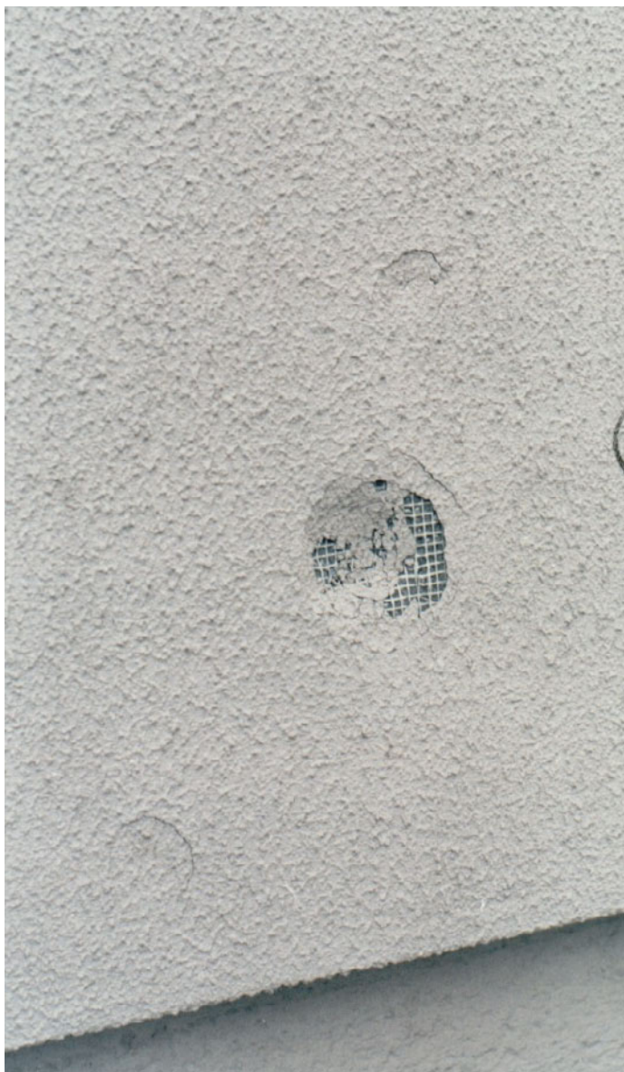
Poškozená výztužná vrstva. Dochází k proražení i při malém úderu.
