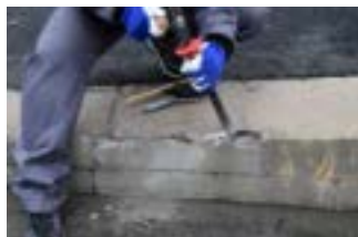
Osekát slabé části narušeného betonu.
